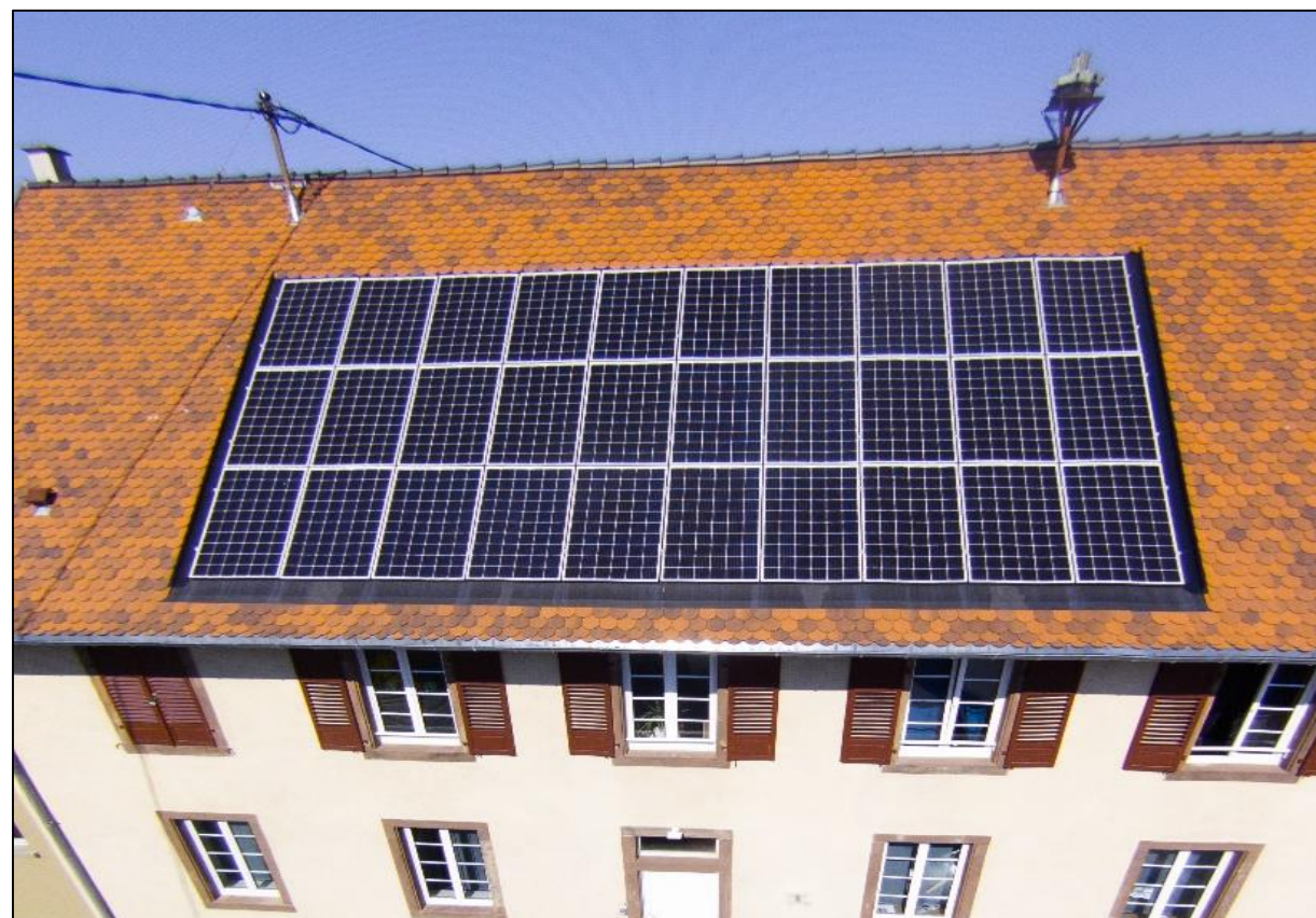
Mairie-école de Thal-Marmoutier 9kWc, 55 m 2 de panneaux
