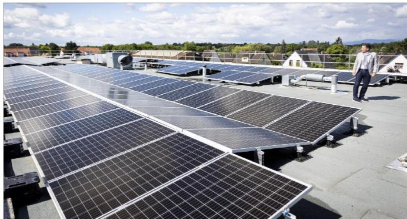
D'une surface solaire de 399 m 2 , l'installation a coûté 86 907 €. La toiture a nécessité une rénovation à hauteur de 132 896 €. Photo DNA/Elyxanro CEGARRA
