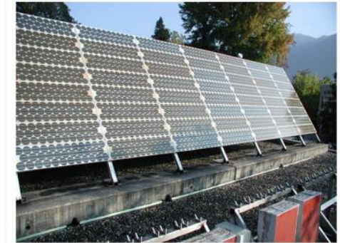
Le système PV a été installé sur le toit du PVLab de l'Université des sciences appliquées à Lugano. Photo : SUPSI PVLab
